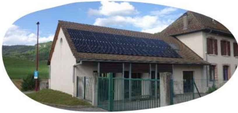
Installations photovoltaïques salle des fêtes et école de Rochefort - mai 2024
